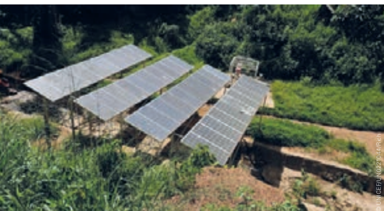
Südsudan: Solarenergie treibt in Yambio eine Wasserpumpe an.
